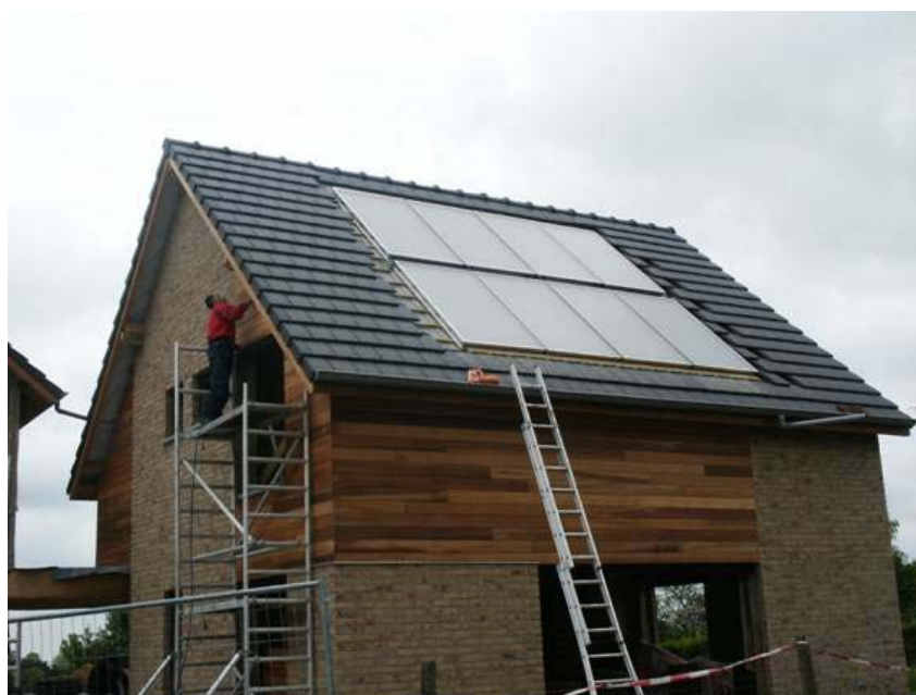
Figure 17 : Photo d'un CES installé en toiture (source : APERe ® )
